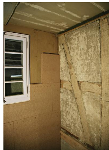
Abb. 3: Wohnhaus, stark sanierungsbedürftig, Innenseite Außenwand, Buetzberg CH
