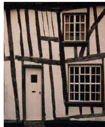
Abb. 2: Wohnhaus, stark sanierungsbedürftig, Ansicht, Buetzberg CH
