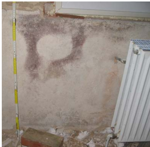
Abb. 3: Nach Entfernung einer Innendämmung aus EPS-Verbundplatten: Schimmelbildung ringsum die Gipsbatzen.
