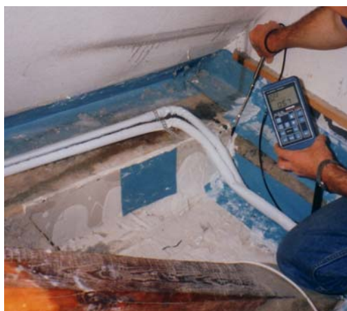
Abb. 5: Luftdichtung bei geöffneter Holzbalkendecke: Abstellung und Abdichtung mit Gips-schlämme gegenüber Unterdecke, aus: [7].
