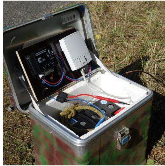
Abb. 21: Aluminium Box der Firma Zarges GmbH mit einer Autobatterie sowie senkrecht die Platte mit Tiefentladeschutz und Axis Switch zur Versorgung der Wärmebildkamera mit Strom. Gleichzeitig dient das Switch zum Zugriff auf die Wärmebildkamera mit dem Laptop.
