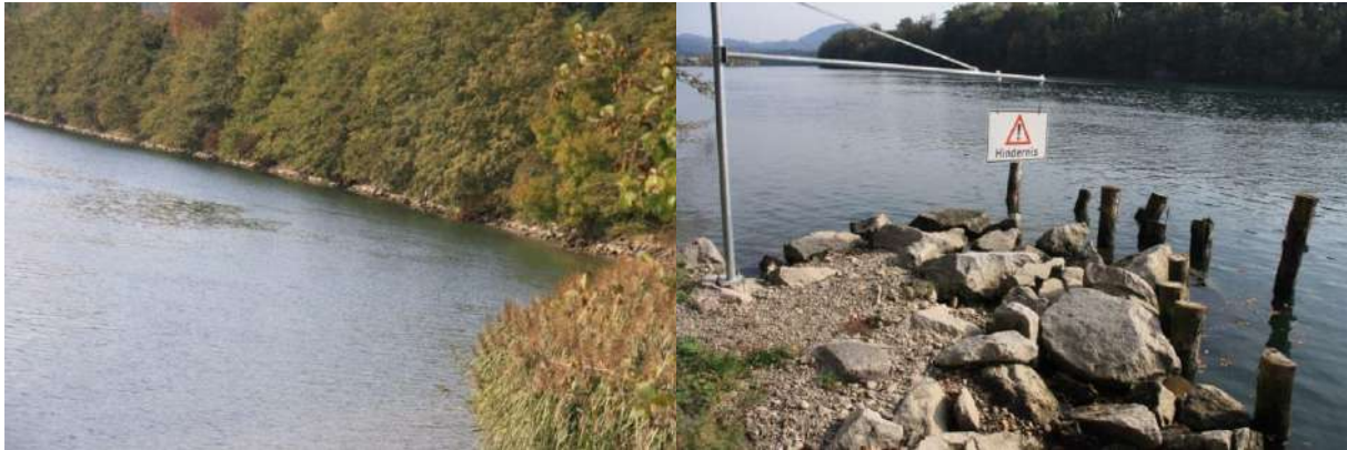
Abbildung 42: Uferbefestigung mit Blockhalden im Teilgebiet U4 (links). Steinbühne zur Beeinflussung der Strömungsverhältnisse beim Rheinkilometer 126 (rechts).
