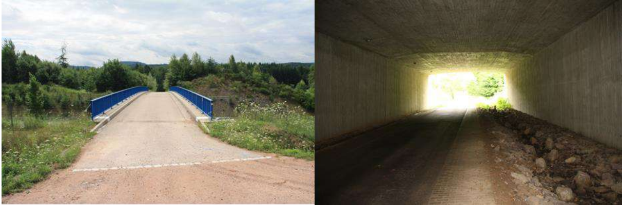
Abbildung 43: Links: Asphaltierte Wirtschaftswegeüberführung bei Murg über die A 98. Rechts: Die Wirtschaftswegunterführung bei Murg (A 98).
