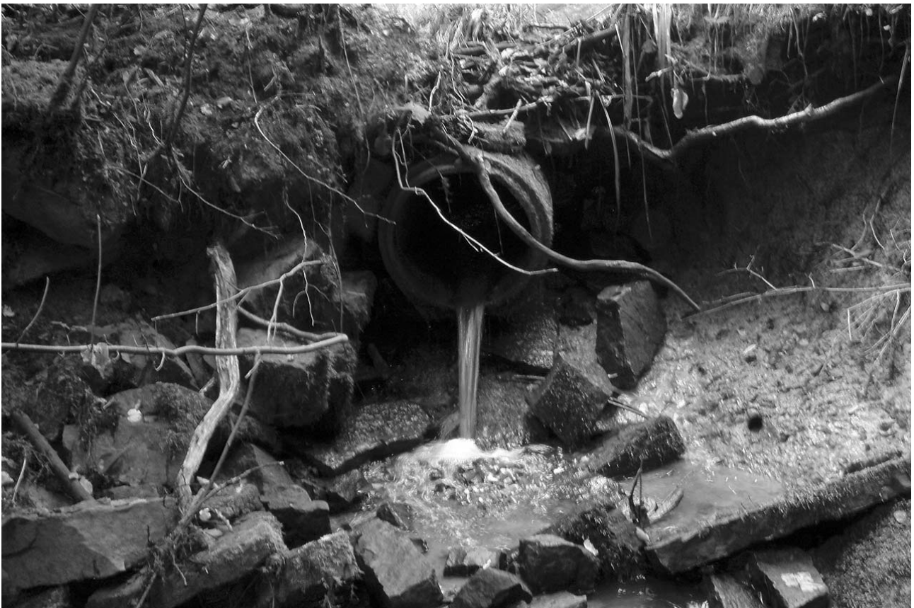
Dole zu hoch eingebaut und damit entgegen der Fließrichtung ein kaum überwindbares Hindernis
